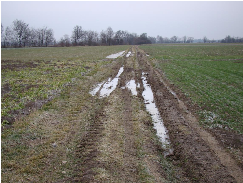
Fot. Nr 2 – Widok w km 0+200 przed wykonaniem. Data: stan w dniu 7 lutego 2020 r.
