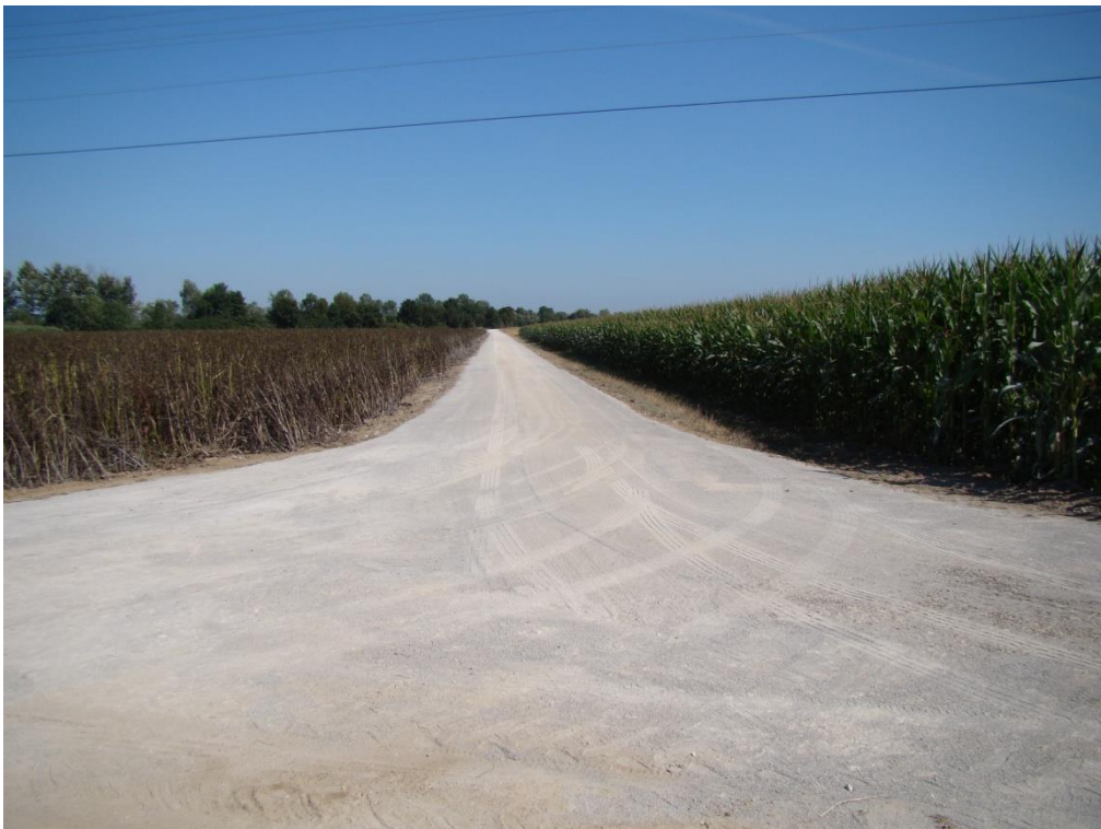
Fot. Nr 1a – Widok w km 0+000 po wykonaniu. Początek modernizacji odcinka drogi. Data: stan w dniu 14 sierpnia 2020 r.
